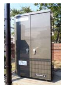
水質連続監視装置
