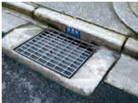
きれいな状態の雨水ます
