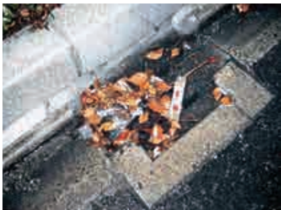
ごみや落ち葉が詰まった雨水ます
