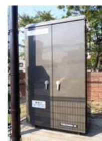
水質連続監視装置
