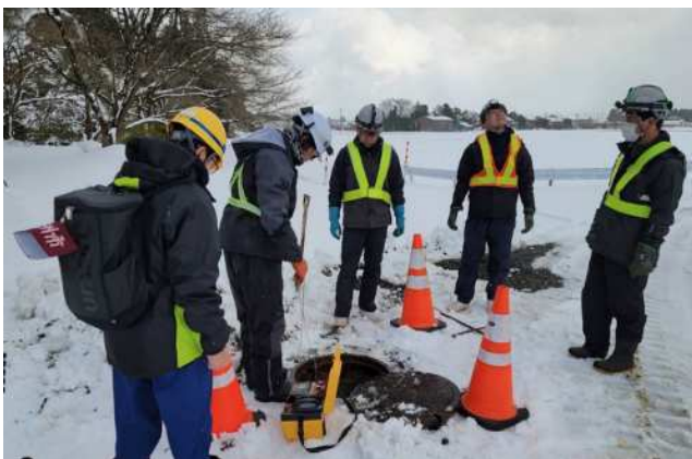
下水道の被害状況調査(令和6年1月)
