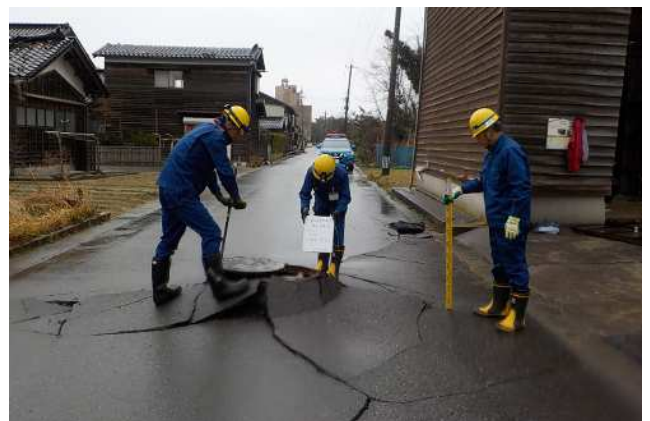
浮上したマンホールの状況調査(令和6年1月)
